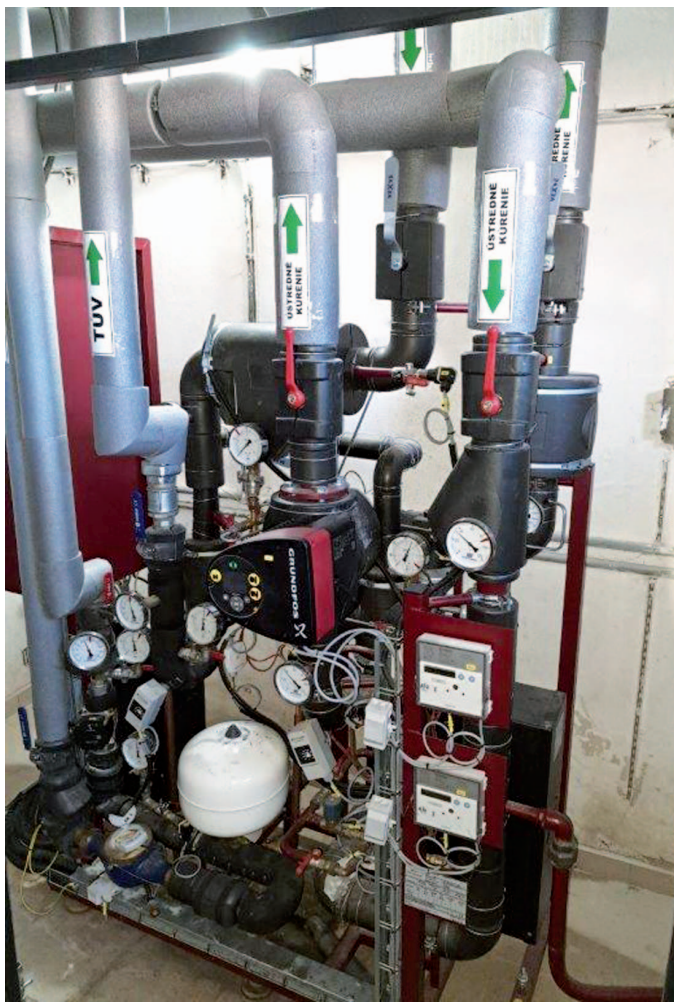
Odovzdávací stanica tepla (OST) – voda na ústredné kúrenie a teplú vodu sa ohrieva priamo v OST umiestnenej v objekte.
